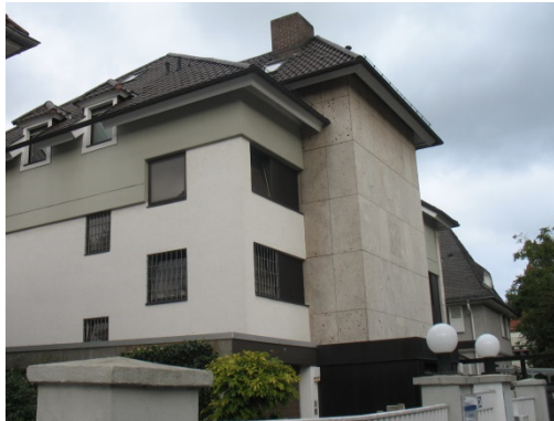
Abbildung 36 - Fensterformate, Materialwahl und Fassadenproportion und Fensterformate nicht ortsbildtypisch, keine Zonierung - Keplerstraße Quelle Stadt Heidelberg
